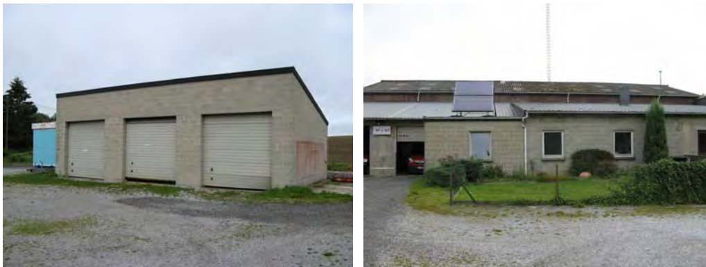
Vue sur l'actuel arsenal des pompiers. Une rénovation des façades de l'ensemble des volumes s'avère nécessaire © S&A - 2011
